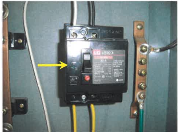
2번 [ LIGHT 차단기(건물측) ]/건물측 관리
