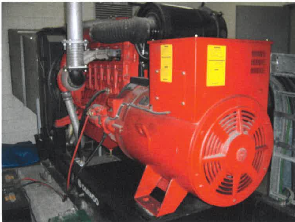
[ 전기실 내부 발전기(비상용) 2 / 건물측 관리 ]
