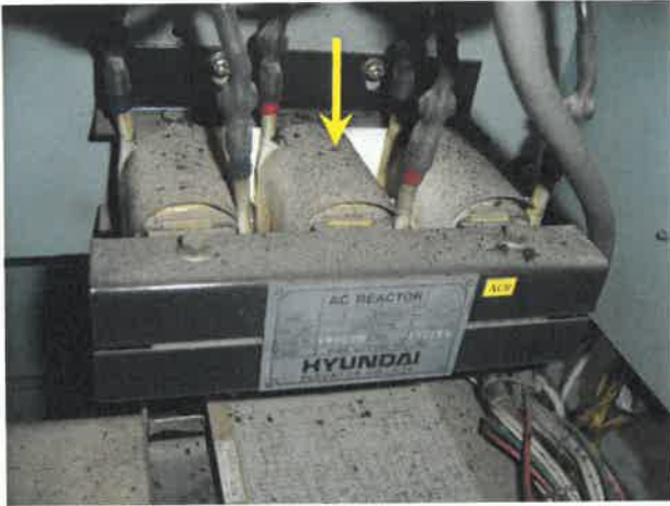
31번 [ AC-REACTOR ]/₩1,163,800원 [교체주기 : 10년]
