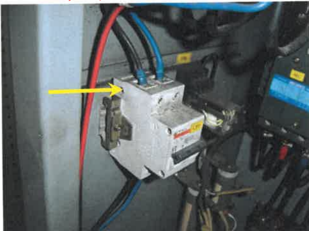
27번[ 제어반 FAN 차단기 ]/₩93,500원 [교체주기 : 3년]
