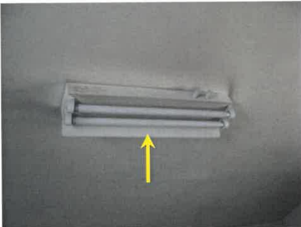
3번 [ 기계실 조명장치 ]/건물측 관리
