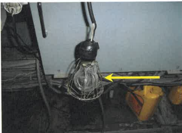
71번[ 카 상부 조명 ]/LED 별도 산정 조명장치(전체) / ₩550,000원(인건비포함) [교체주기 : 3년]
