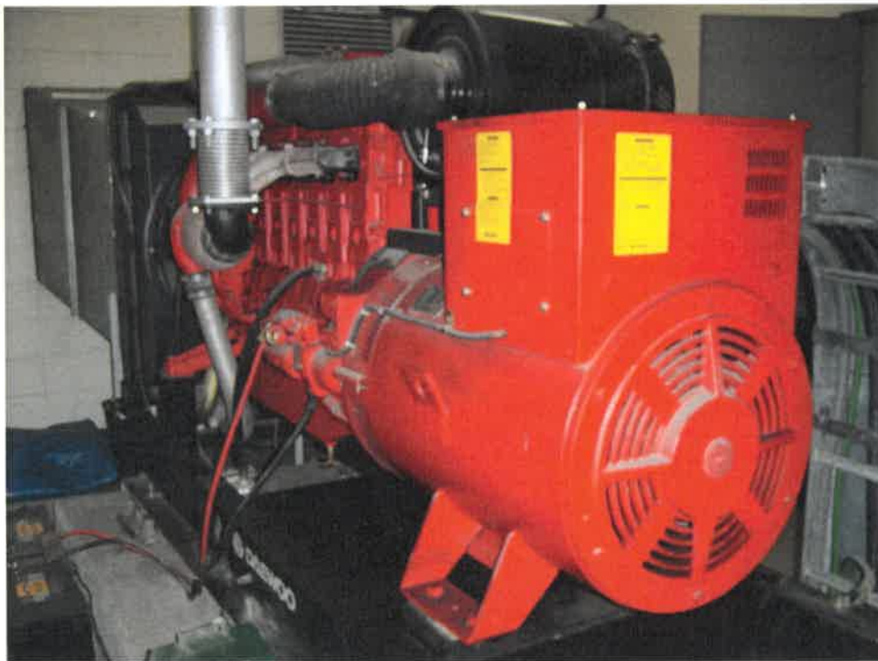
[ 전기실 내부 발전기(비상용) 2 / 건물측 관리 ]
