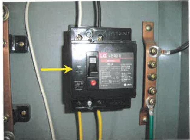
2번 [ LIGHT 차단기(건물측) ]/건물측 관리
